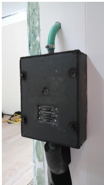
Messbox der Messeinrichtung in/hinter der Innenwand (geschlossener Zustand)
