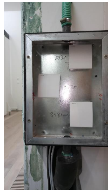
Innenleben der Messbox mit den drei Fühlern der Gebäudeautomation
